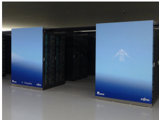
Fugaku-Supercomputer (Quelle: Fujitsu)
